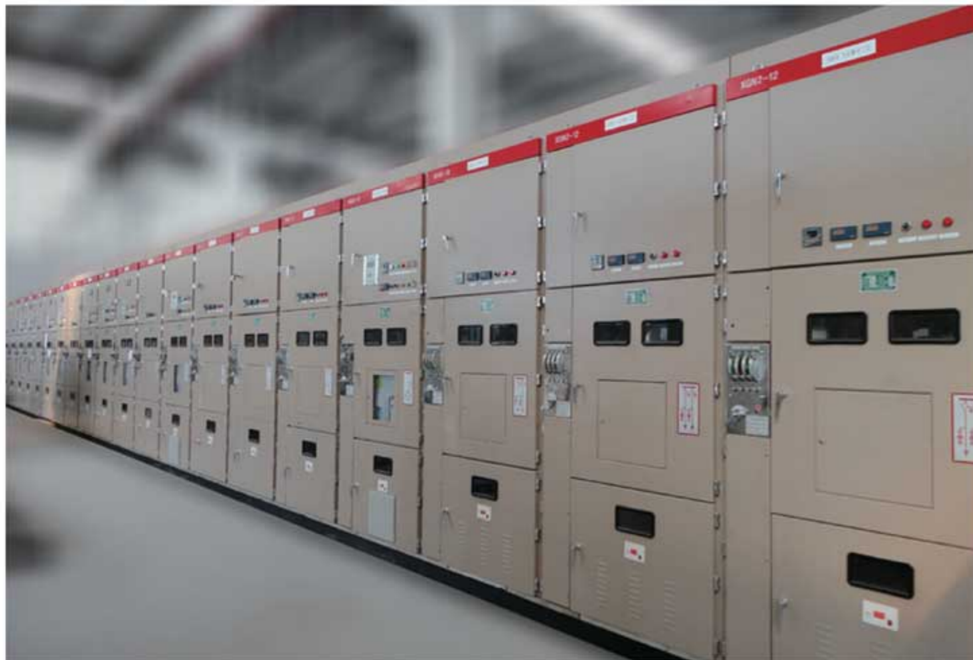
• Распределительные ячейки высокого напряжения
